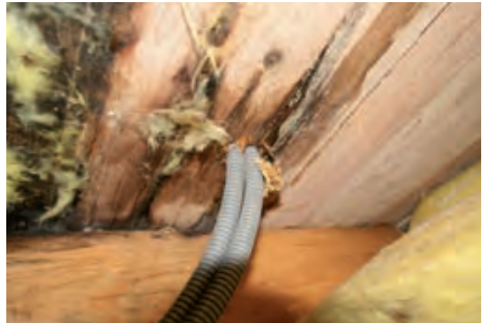
Immer wieder sinnlose Diskussionen wozu luftdicht gebaut werden muss. Hier ein ein Pilzschaden schon nach einem Jahr!
