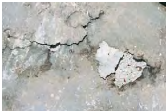
Unterseitenkorrosion durch vollflächige Verklebung verhindern.
