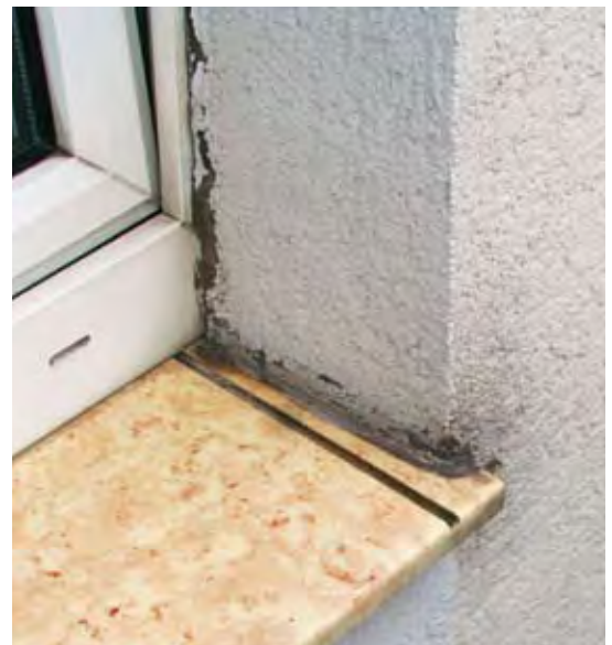
Ein Bauschadensklassiker: Wartungsfuge hinten und seitlich mit Silikon, alle zwei Jahre undicht.
