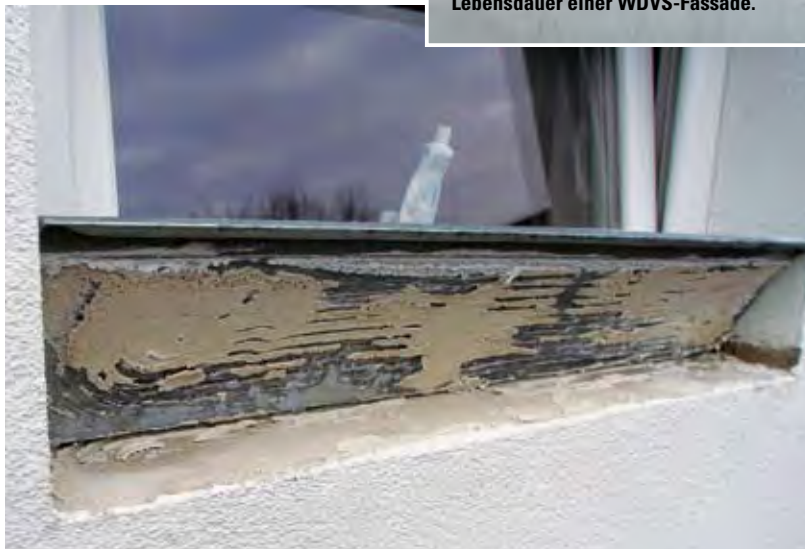
Oberputz fehlt – Hohlstellen im Kleber führen bspw. zu Unterseitenkorrosion durch Tauwasser.
