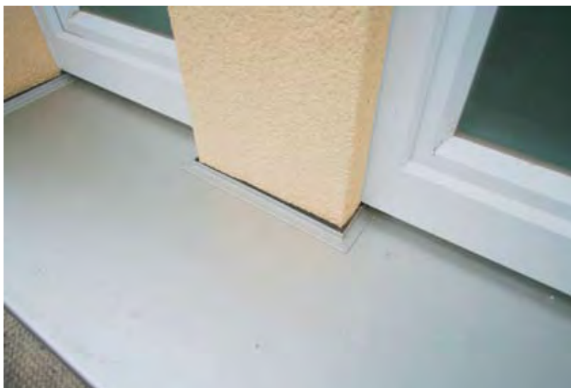
Weichzellschaumbänder sind nicht stauwasserdicht – diese Sohlbank auch nicht.
