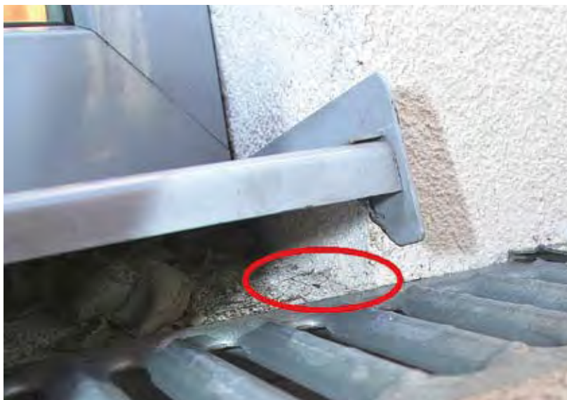
Kompriband nach Wasserprobe durchlässig + Riss im Oberputz bedeutet Wasserschaden!
