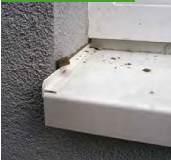
Die Fugenbreite muss geplant und überwacht werden, Kompriband am falschen Ort, falsch eingebaut.
