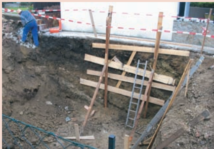
Fahrlässige Baugrubensicherung. Das Nachbarfundament droht abzurutschen
