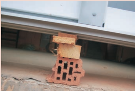
Notlösung aus Holz und Ziegel: Die Türschwelle wurde falsch eingebaut und hängt in der Luft
