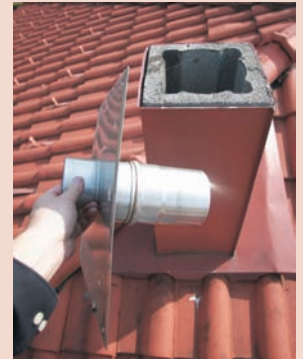
Eine fehlerhafte Kaminaufstellung führt oft erst Jahre später zu schweren Sturmschäden
