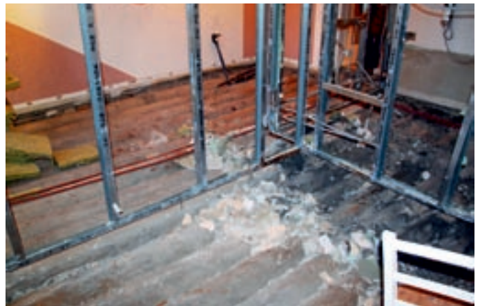
Nach festgestelltem Pilzschaden musste die Decke freigelegt werden
