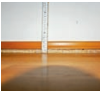
So viel der massive Deckenschaden erst auf – mittige Senkung!
