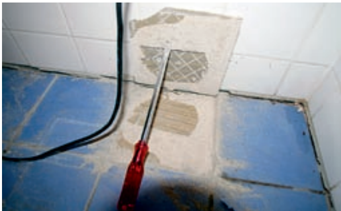
Die Randfugen sind offen für Wassereintritt, die Abdichtung fehlt
