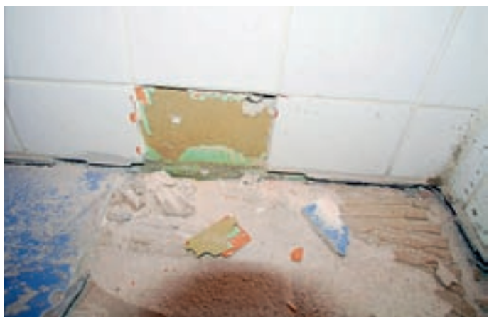
Boden- und Wandabdichtung fehlt, die Anschlussfuge ist gänzlich offen
