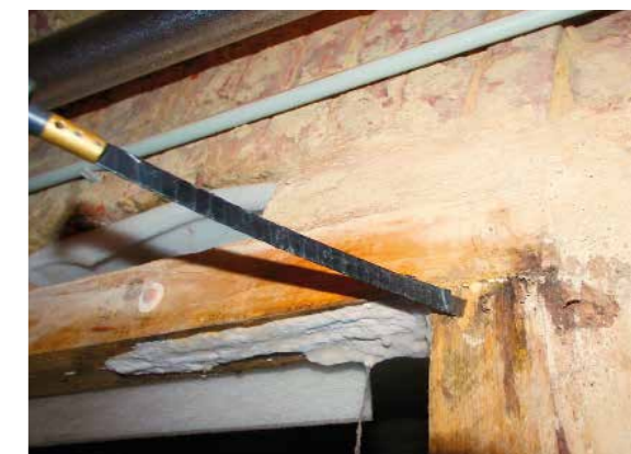
Die in alten Kellern üblichen hölzernen Türrahmen haben viele Jahrzehnte in feuchter Umgebung ausgehalten. Bis der Hausschwamm kam.
