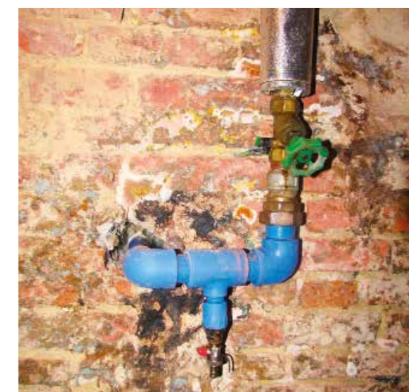
Sporen und Feuchtigkeit an Metallinstallationen: Der Fäulepilz bildet Fruchtkörper und wartet auf seine Gelegenheit.
