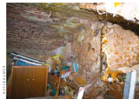
Es tropft von der Decke: Holz und Holzwerkstoffe legen sich neue, schlechtere Werkstoffeigenschaften zu.
