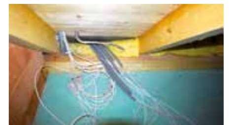
Trotz Firstabluft starker Schimmelbefall aufgrund luftundichter Elektroinstallationen
