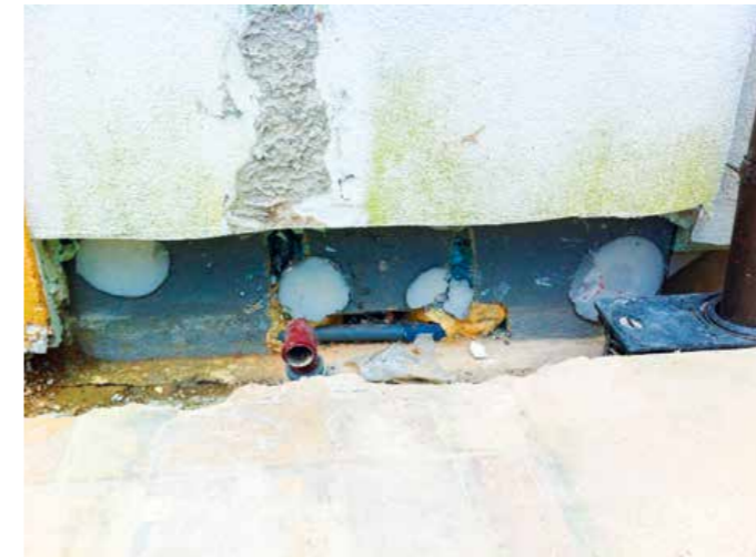
Ein nur punktwise verklebter Sockel führt Kleintiere und Insekten direkt ins Gebäude.
