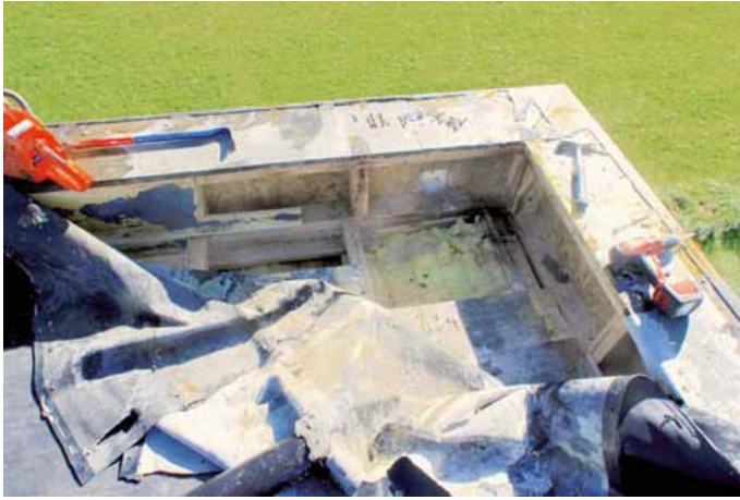
Holzfeind Nr. 1 bleiben Luftundichtheiten an der Dampfbremse, die nach wenigen Jahren zur Holzzerstörung führen.
