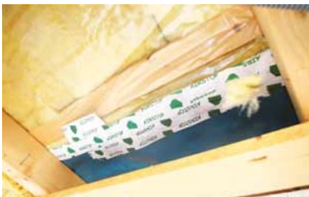
Hier hat die Baufirma bereits nachgebessert, aufgrund Undichtheit dann der Hausher nochmals – dünne Folien als Herausforderung.
