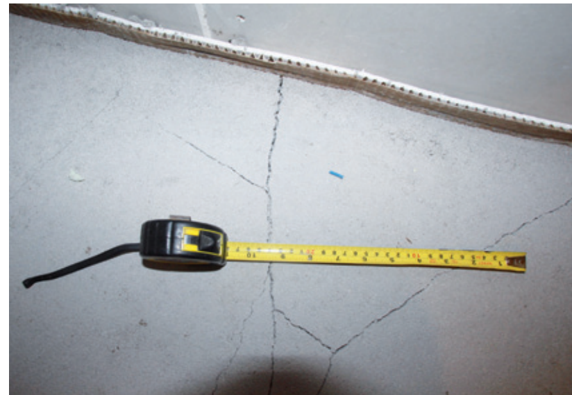
Estrichrisse sind durchaus reparabel, bei derartigen Bruchstücken aber nicht mehr.
