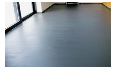
Eine Estrichsanierung ist technisch durchaus möglich, das muss aber im Einzelfall beurteilt und entschieden werden
