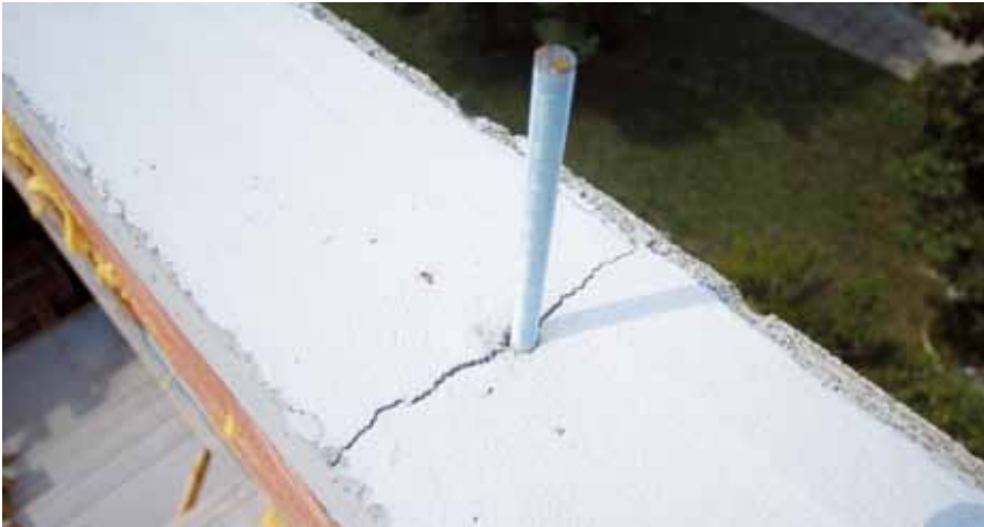
Der Betonkranz wurde bei Sommerhitze ohne Abdeckung betoniert. Risse bei jeder Gewindestange sind die Folge.
