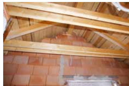
Bei der Giebelwand fehlen ein Ringbalken und der Ringanker als Mauerabschluss.
