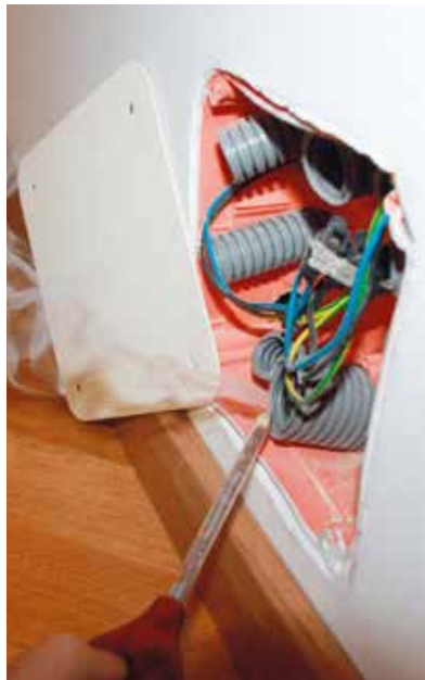
Elektroinstallationen sind eine der Hauptursachen für Kondensationsschäden
