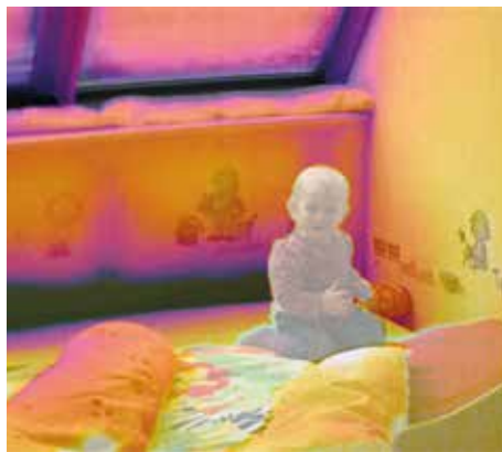
40 cm Dämmung sind in diesem Beispiel aufgrund von Windundichtheiten völlig unbrauchbar.
