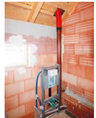
Hier hätte vor der Vorwandinstallation verputzt werden müssen.
