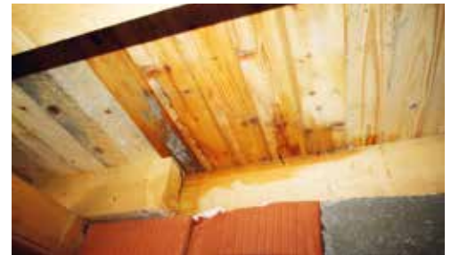
Kondensationsschaden bei Massiv-Mauerwerk durch fehlerhafte Sanitärinstallation
