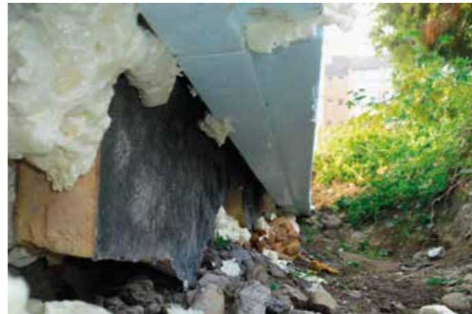
Dämmen ist Planungssache - solche Dämmkatastrophen rechnen sich nur für den Verarbeiter.
