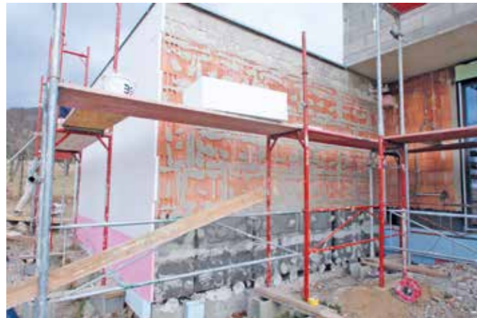
Die oft falsche Verarbeitung von guten Dämmsystemen schadet der guten Idee, Gebäude besser zu dämmen.
