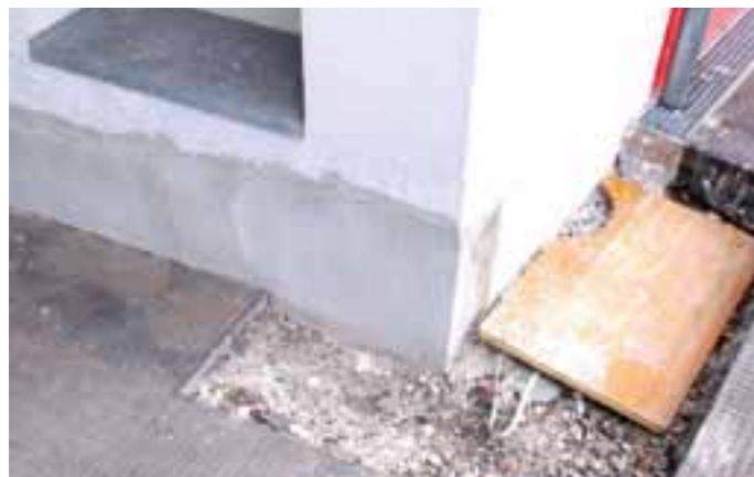
Normalbild: Bei der Sanierung war mit freiem Auge nicht erkennbar, dass der gesamte Sockelbereich bereits geschädigt war.
